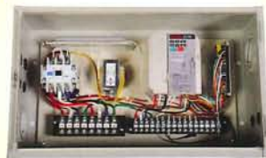
走行用制御盤 (0.75kw×2)
